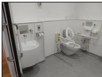
新宮市 障がい者用トイレ
