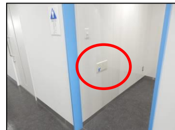
兵庫県洲本市 トイレ音声案内設備
