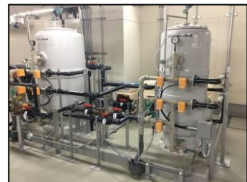
紀の川市 井水ろ過装置
