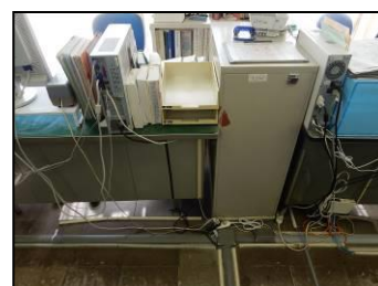
社会福祉課執務室 コード類の接続状況
