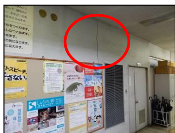
本庁舎 壁の亀裂
