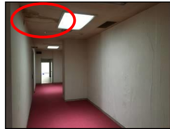
議会棟 廊下天井の漏水
