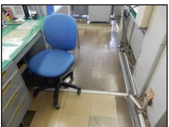
社会福祉課執務室 床に直接設置されている ケーブル
