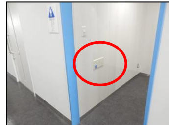
兵庫県洲本市 トイレ音声案内設備
