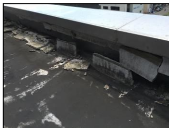
本庁舎 屋上 笠木の破損・崩落
