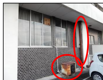
本庁舎 排水管等の錆び付き
