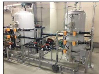
紀の川市 井水ろ過装置
