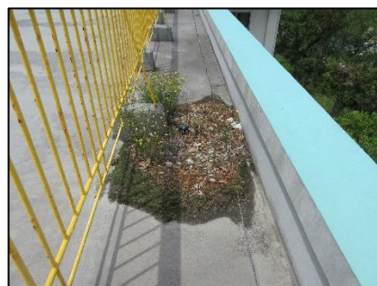
屋上排水口の詰まり
