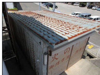
屋根材（鉄部）の発錆
