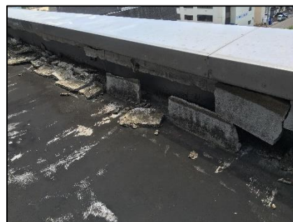
屋上立ち上がりパラペットの破損
