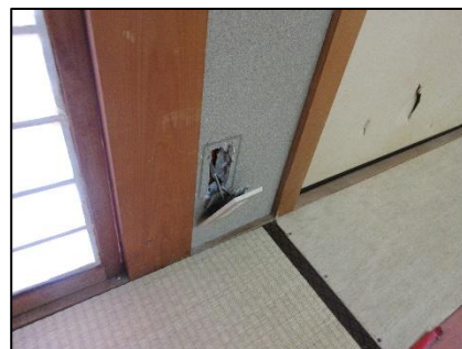
コンセントの破損
