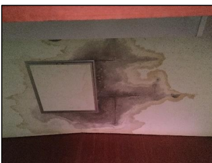
天井の雨漏れ・漏水
