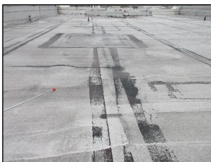
屋上防水シートの膨らみ、破損 伸縮目地の破損
