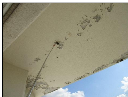
軒天の塗膜剥離・露筋
