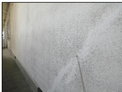
外壁のひび割れ・亀裂 シーリングの劣化
