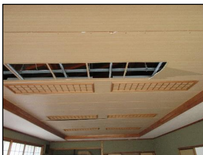
天井ボードの脱落
