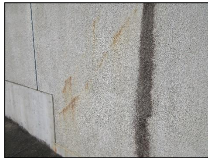
外壁の亀裂、錆汁
