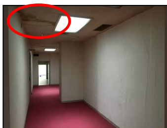
議会棟 廊下天井の漏水
