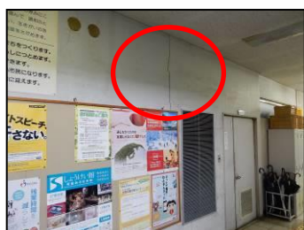
本庁舎 壁の亀裂
