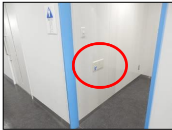
洲本市 トイレ音声案内設備
