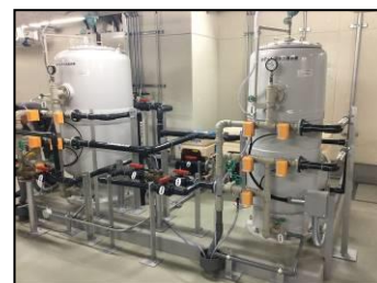
紀の川市 井水ろ過装置
