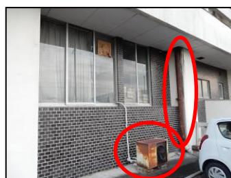
排水管等の錆び付き
