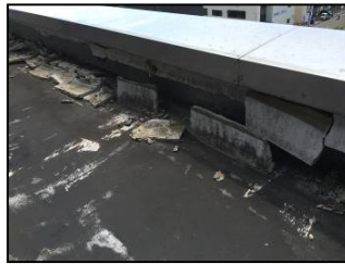
本庁舎 屋上 笠木の破損・崩落
