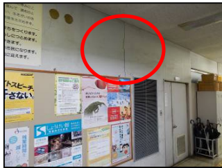
本庁舎 壁の亀裂
