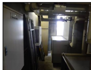
本庁舎機械室 空調設備の 老朽化・陳腐化
