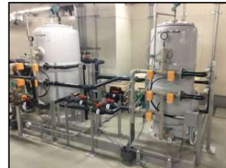
紀の川市 井水ろ過装置
