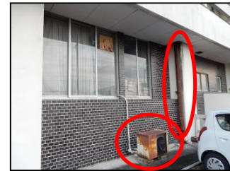
本庁舎 排水管等の錆び付き
