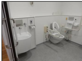
新宮市 障がい者用トイレ
