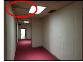
議会棟 廊下天井の漏水
