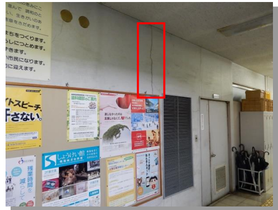
市役所 1 階玄関フロア付近 壁のひび割れ
