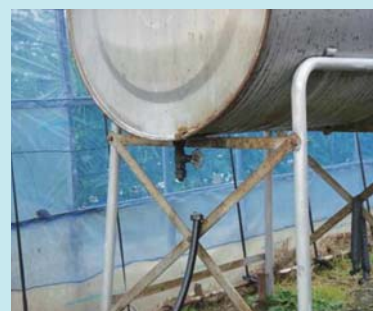
▲配管が外れた状態
